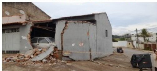
Colisão de Veículo em Edificação
