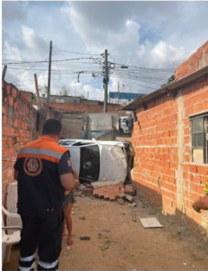
Colisão de veículo em edificação
